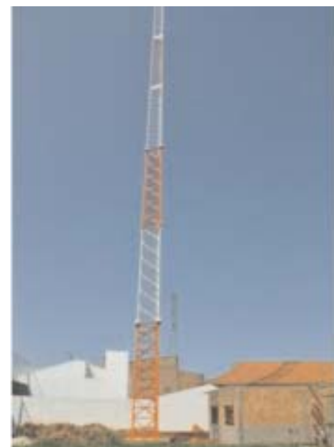
Antena de rádio instalada em Pirangi/SP
